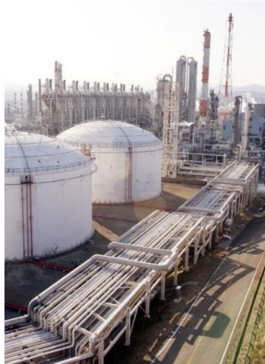
油類および化学品タンク内外部
